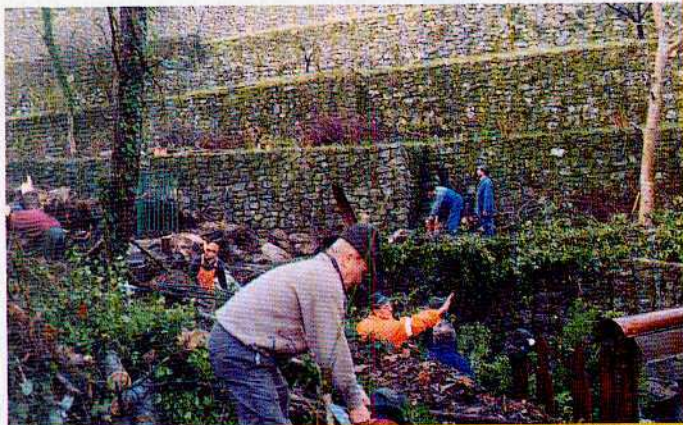
Due momenti dell'intervento dei volontari alpini: la pulizia dei gradoni e la bonifica dell'alveo di un torrente.
