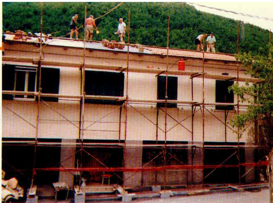
Rifacimento del tetto di una palazzina: al lavoro sono gli alpini bresciani.
